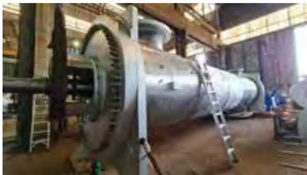
O reator de pré-tratamento é o maior equipamento da planta de E2G
